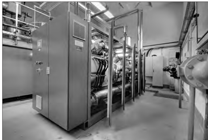
Im Jahr 2009 wurde ein neues BHKW im Wohngebiet auf den Liethen in Heiligenstadt installiert. (Quelle: EW)
